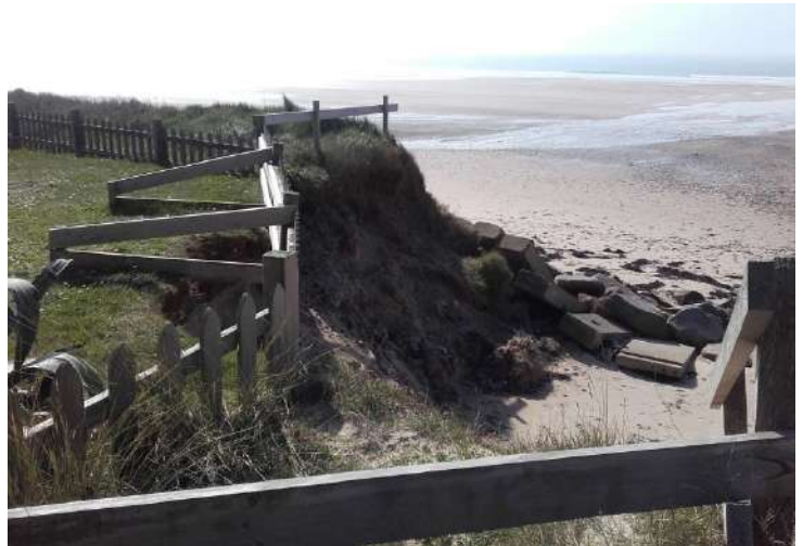
Le coin de la parcelle 104, très fragile et à moins de 15 mètres de la maison
