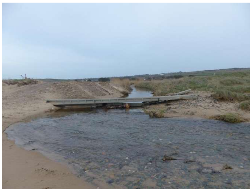
État actuel du pont à l'embouchure de la rivière « Le But »
