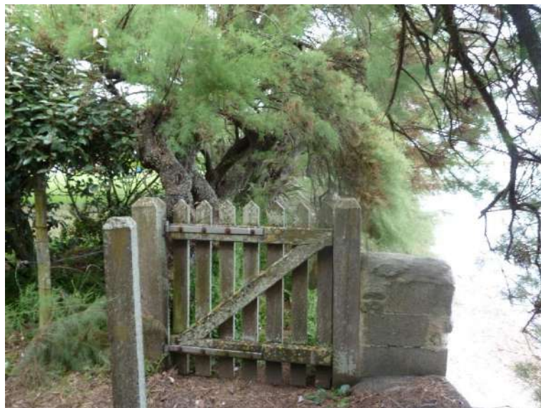
A hauteur du chemin d'Isamberville, le passage est possible mais peu sécurisant : il y a un manque manifeste d'entretien de la SPPL
