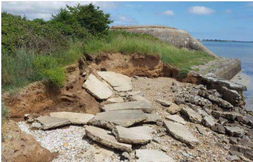
État de la digue sur laquelle passait le sentier littoral
