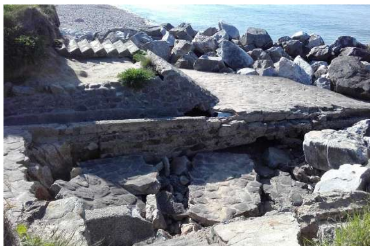
La cale qui s'effondre de tempête en tempête pose de surcroît un problème global de sécurité du public
